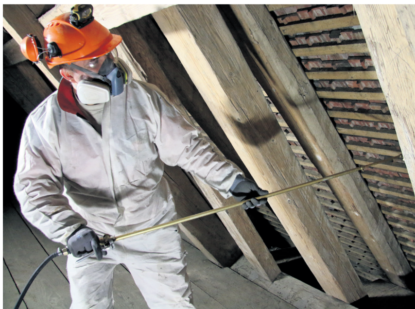
Fachmann Huseyin Isikli behandelt die vom Holzwurm befallenen Balken im Estrich der Kirche.
